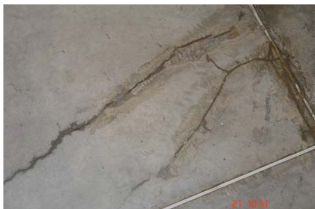
Рисунок 2. Трещины на плите
