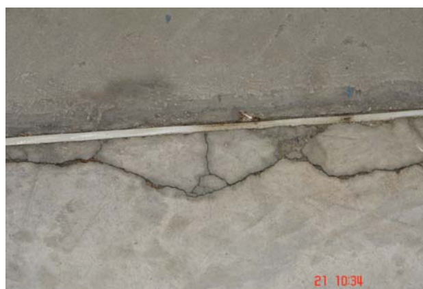
Рисунок 3. Трещины на шве и плите. Причина - неправильная технология и конструктив
