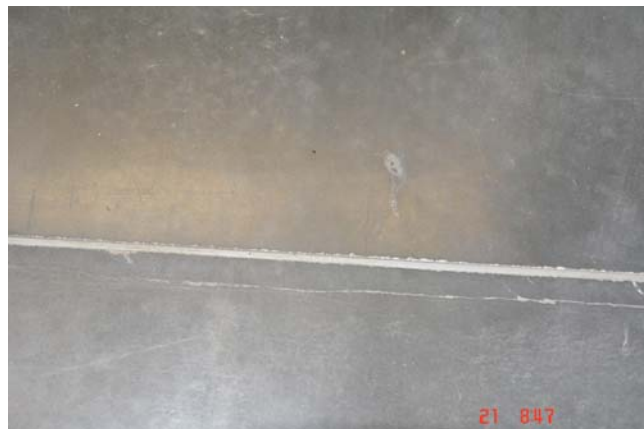
Рисунок 1. Трещина на шве. Следствие неправильной технологии
