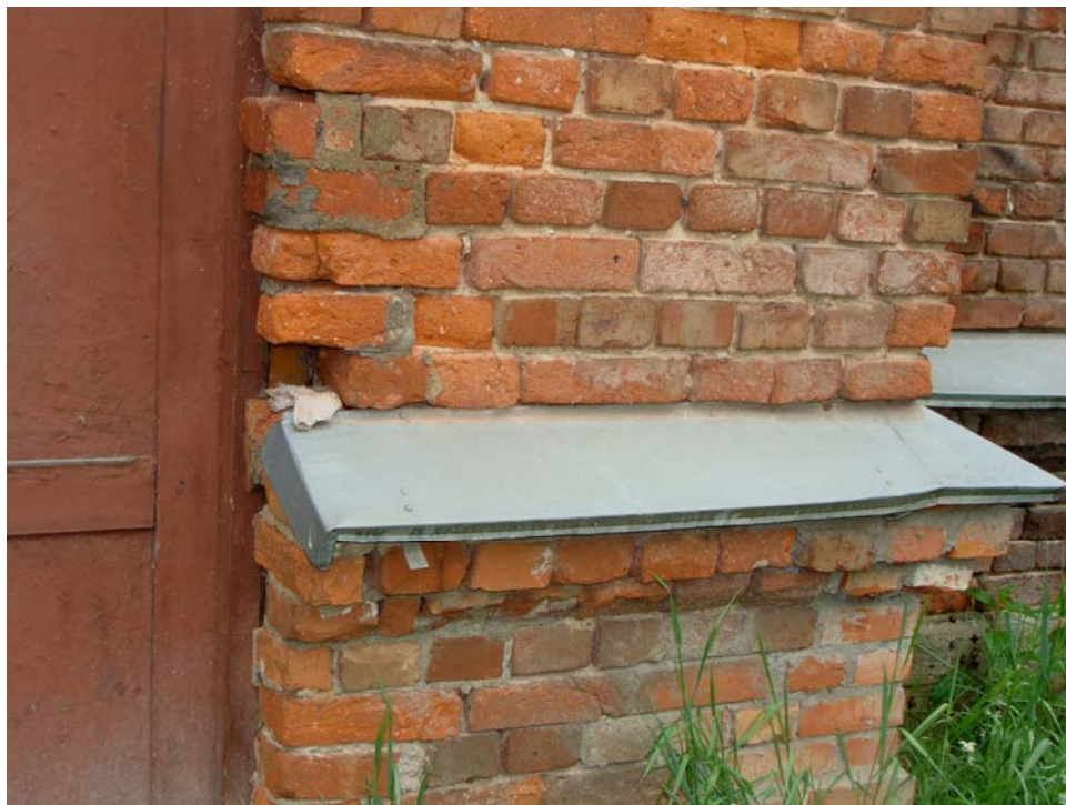
Рисунок 2. Разрушение кладки: выветривание раствора, кирпича, вывал кирпича из кладки
