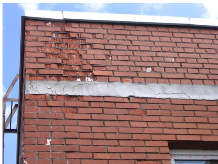
Рисунок 4. Повреждение кладки в месте замочаний в месте постоянного попадания влаги
