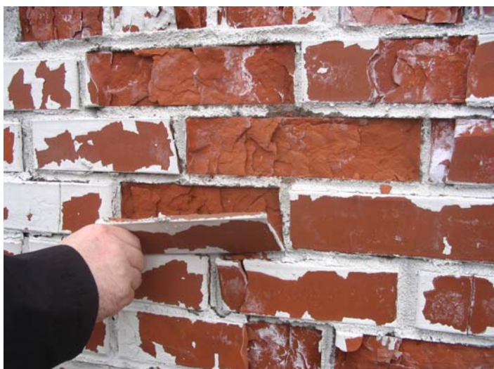
Рисунок 3. Разрушение кирпича в отделочном слое от размораживания кирпича
