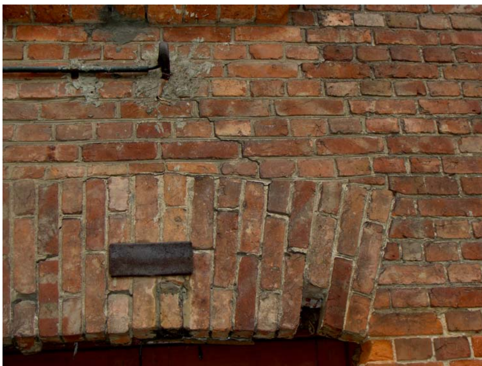
Рисунок 1. Трещина в кирпичной перемычке наружной стены
