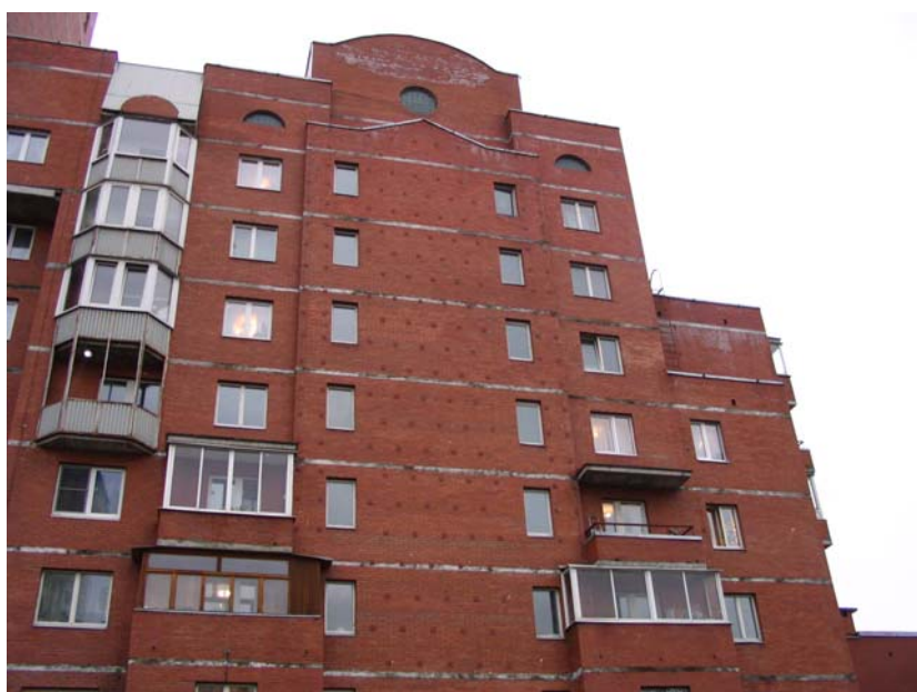
Рисунок 6. Наглядное состояние объекта с многочисленными дефектами кирпичной кладки в отделочном слое: высолы, замокания в местах выступающих плит, отсутствие связи отделочного слоя (дополнительные крепления)
