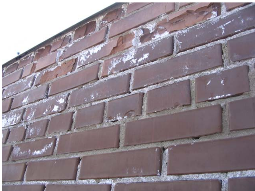
Рисунок 5. Высолы на стене в месте замоканий при неправильно выполненном открытии парапета
