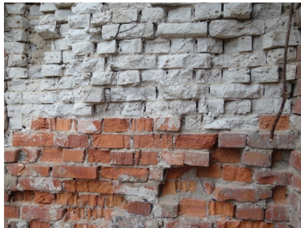
Рисунок 4. Фото поврежденной стены здания
