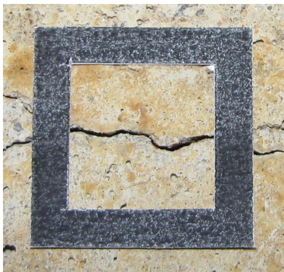
Рисунок 1. Измерение коррозионной трещины с использованием рамки для масштабирования
