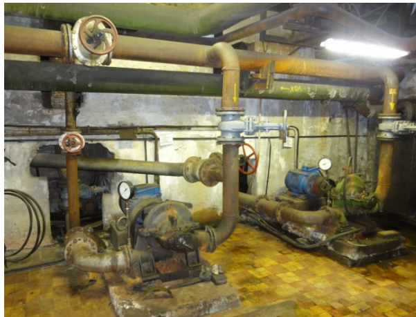
Рисунок 2. Общий вид одной из подсистем теплоснабжения
