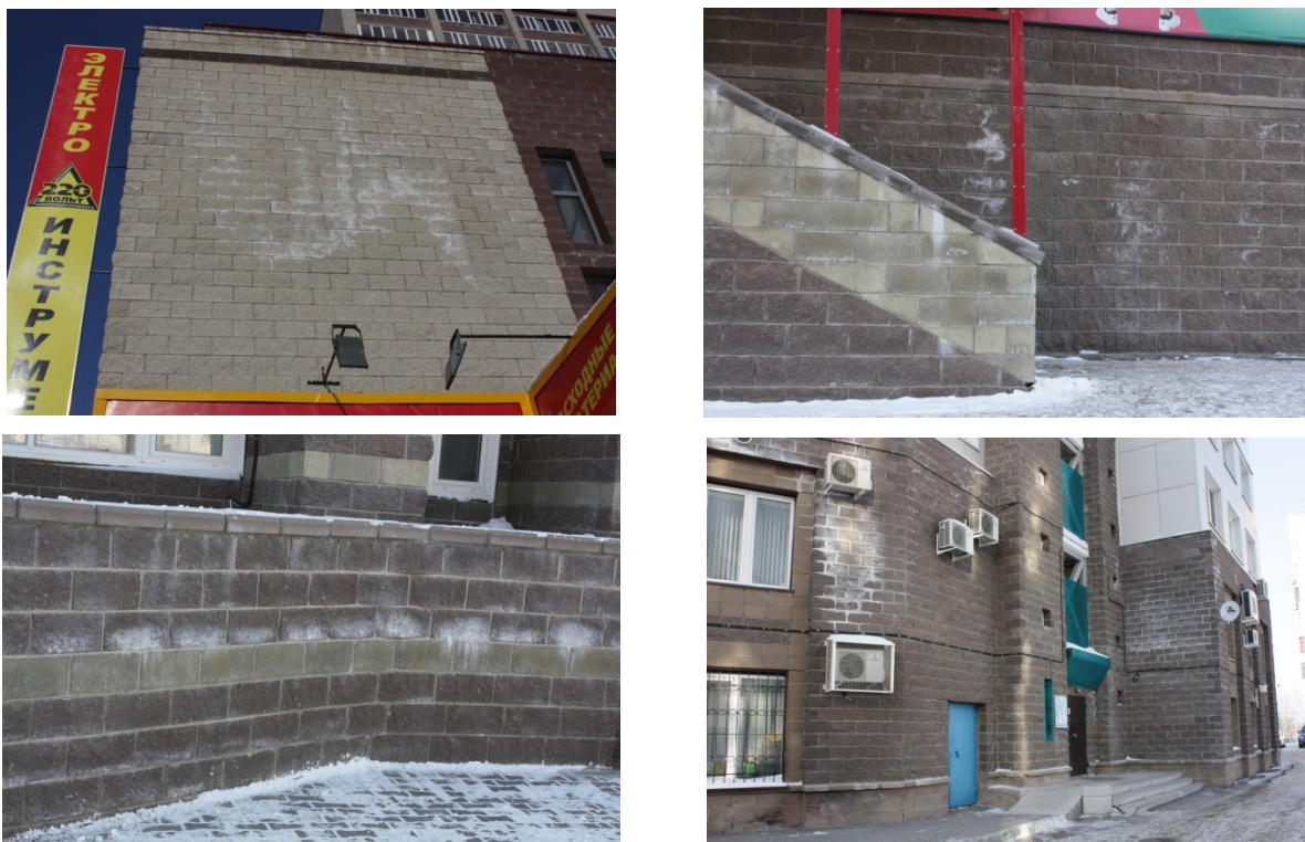
Рисунок 1. Высолообразование на поверхностях наружных стен зданий на основе вибропрессованных бетонных блоков
