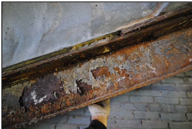
Рисунок 10. Коррозионное повреждение элемента фермы
