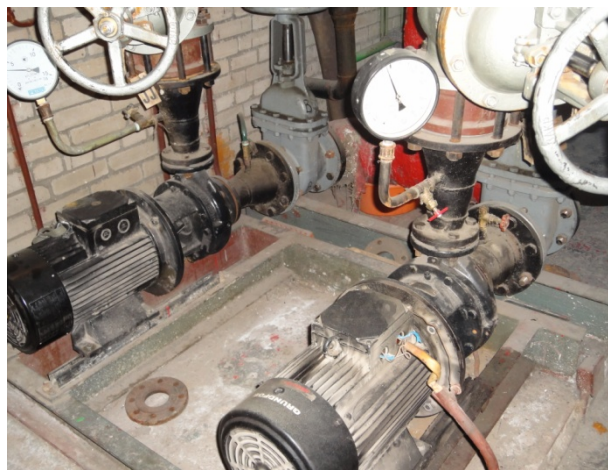
Рисунок 3. Насосы горячего водоснабжения Grandforce второго типа
