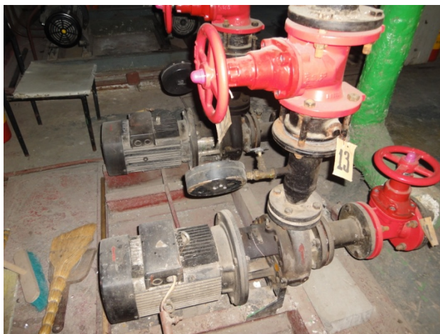
Рисунок 2. Насосы горячего водоснабжения Grandforce первого типа
